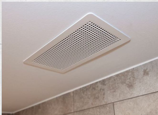
Ognuno dei nuovi appartamenti dispone di un'autonoma ventilazione meccanica controllata HomeVent®.
