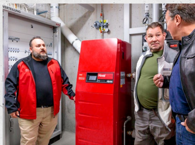
Una caldaia a condensazione a gas UltraGas® 50, in combinazione con un bollitore ESSR 100 Hoval, riscalda una superficie abitabile di circa 1500 m 2 .
