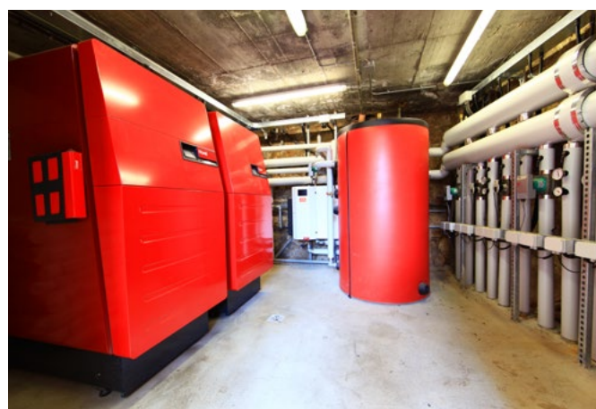
La soluzione completa di Hoval per il riscaldamento e la preparazione di acqua calda nel resort Cappuccini.
