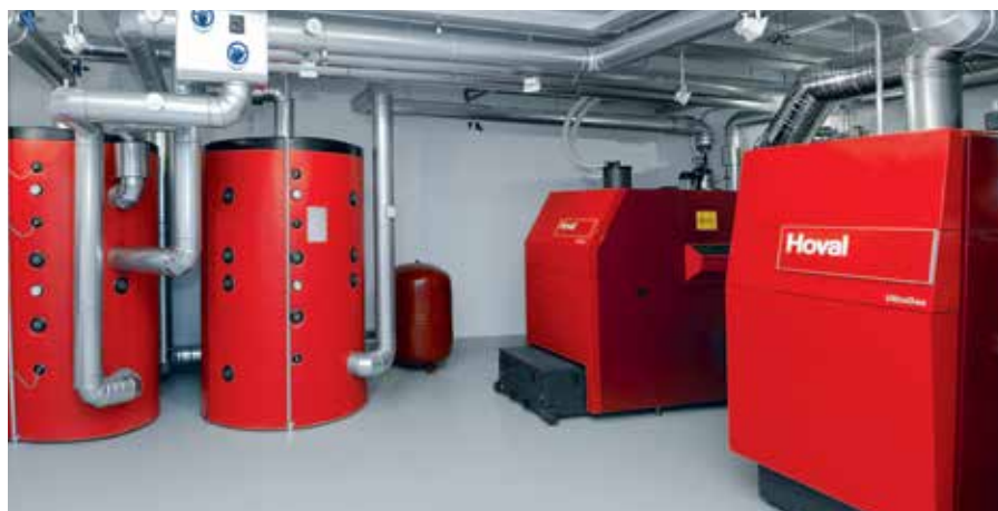
Cascata bivalente in un edificio commerciale nel comune di Aschheim (Monaco): caldaia a pellet BioLyt (160) per il carico base e caldaia a gas a condensazione UltraGas® (250) per la copertura dei carichi di picco.
