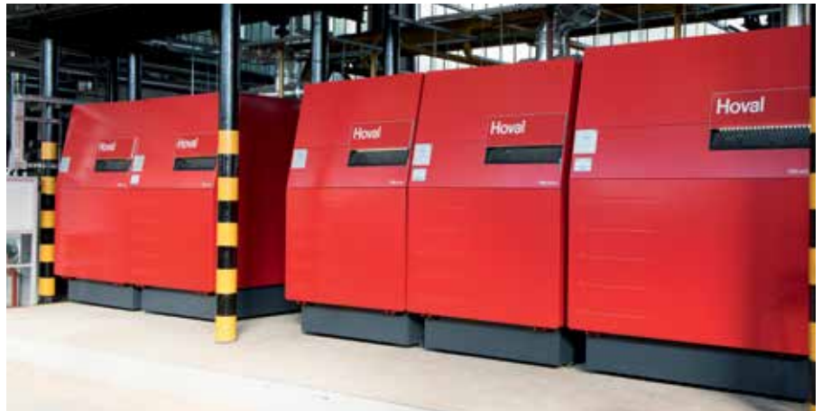
Centrale termica per una rete di teleriscaldamento a Gyöngyös, Ungheria: 1 UltraGas® (1000) e 2 caldaie doppie UltraGas® (1300D) forniscono calore e acqua calda sanitaria a 1578 unità abitative. La distribuzione del carico su 5 caldaie offre un adattamento ottimale della potenza e la massima efficienza, con un'elevata garanzia contro i guasti.
