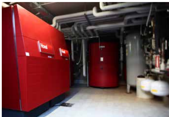
Cascata monovalente costituita da 2 UltraGas in un complesso residenziale di Settimo Milanese (MI)
