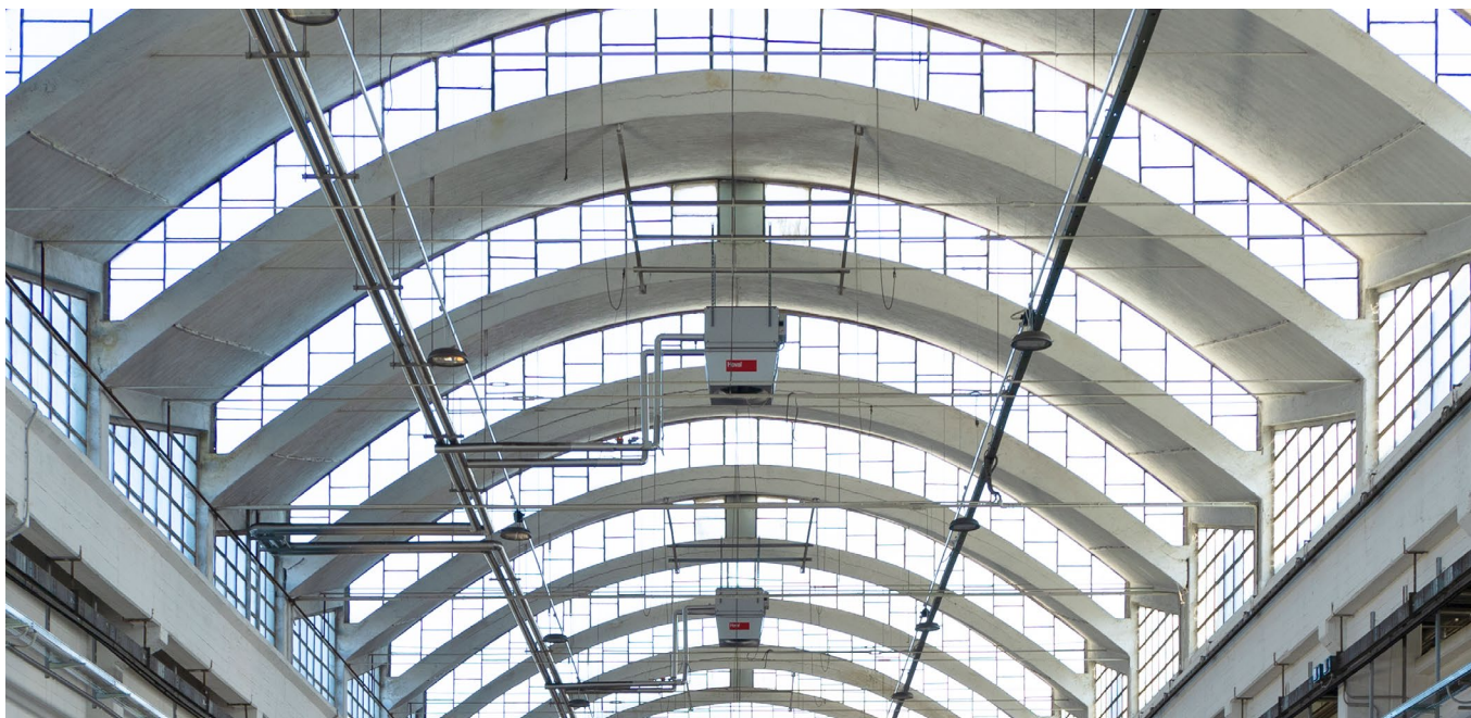
Esempio di impianto di ventilazione industriale.
